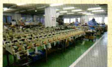
工場には必ずある制御盤。複雑な配線が正しく繋がれているか、念入りにチェックが行われる。
