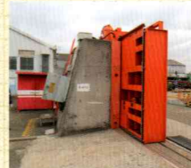
重さ9トンもある電動の防潮鉄扉は、停電時には手動のハンドルでも軽く動かすことができる。
